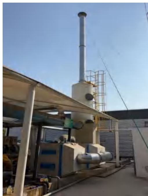
污水处理站异味废气治理设施
