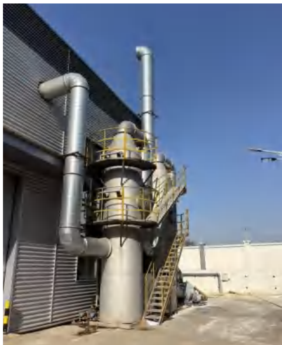
制浆异味废气治理设施
